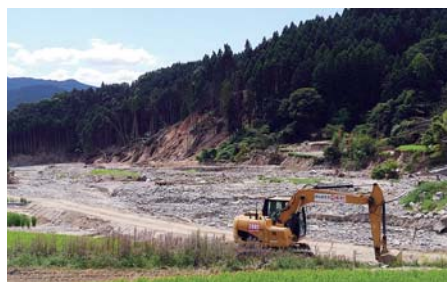
土砂崩れにより大きな被害が出た朝倉市
